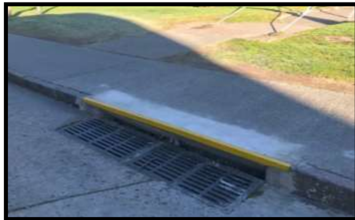
Figura 3. Sumidero de rejilla (Fuente: Municipio de Olavarría)
