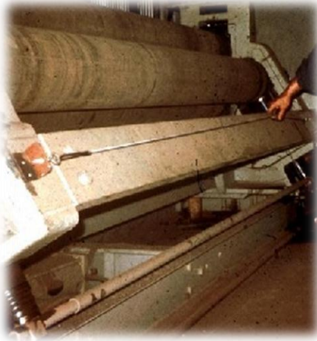
IMAGEN 12.3.- Cables del Activador de Seguridad
