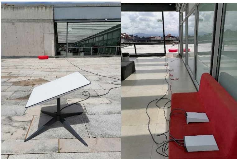
Figura 26 Antena STARLINK instalada
