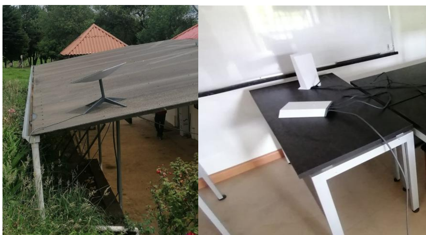
Figura 28 Antena STARLINK instalada
