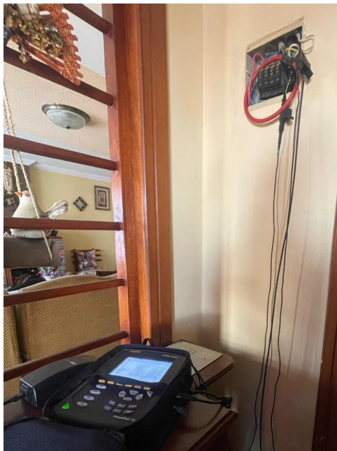
Figura 3–2: Instalación del medidor de calidad energético en la vivienda. Fuente: [Propia]
