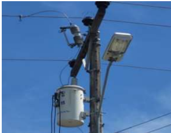
Figura 3.7. Fotografía tomada al transformador TR_1F_25947 del estrato D
