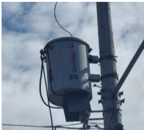
Figura 3.4. Fotografía tomada al transformador TR_1F_3513 del estrato C.
