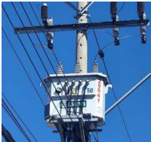
Figura 3.1. Fotografía tomada al transformador TR_3F_29641 del estrato B.
